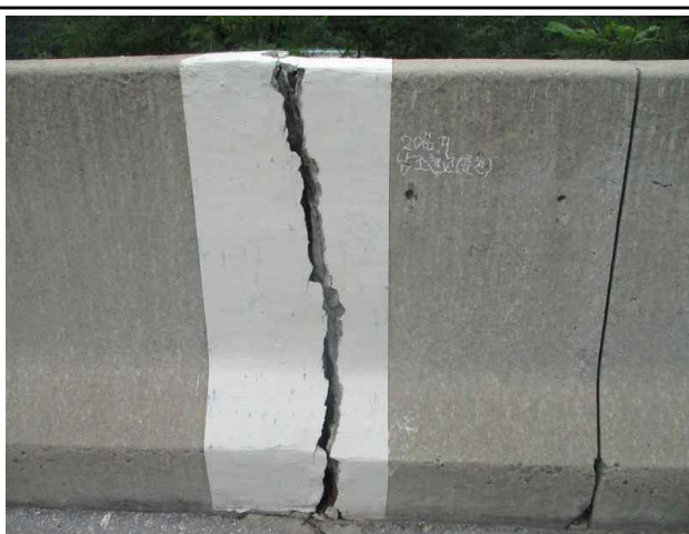
방호벽(날개벽-접속부) 파손 현황
